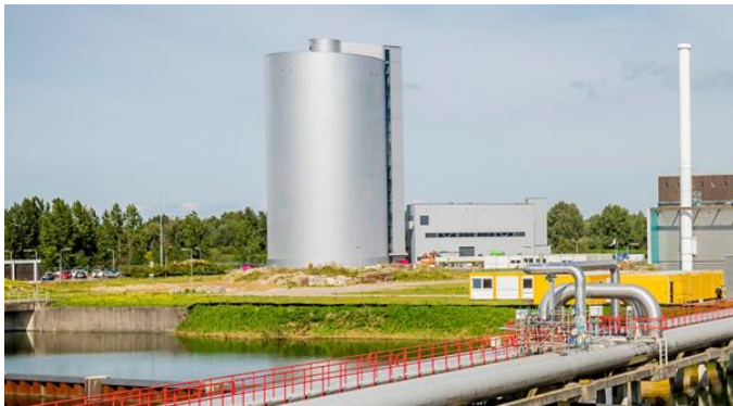
Afbeelding 1.12 Bovengrondse warmteopslagtank Diemen
